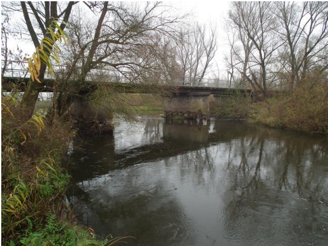
Fotografia nr 6 Most na rzece Widawce w miejscowości Ligota - nieprzejezdny, - zniszczone podpory i struktura jezdni.
